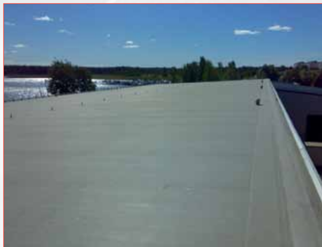
Vakuumentiler i rand- och mittzon
